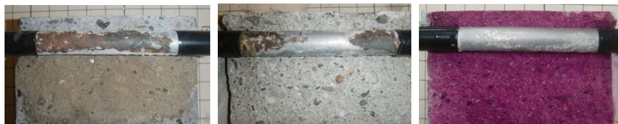
(a) 65-5-5-Cl 腐食促進 65 日 (b) 65-5-5-Cl ひずみ測定 (c) 65-5-0-C 腐食促進 171 日 腐食促進 141 日
