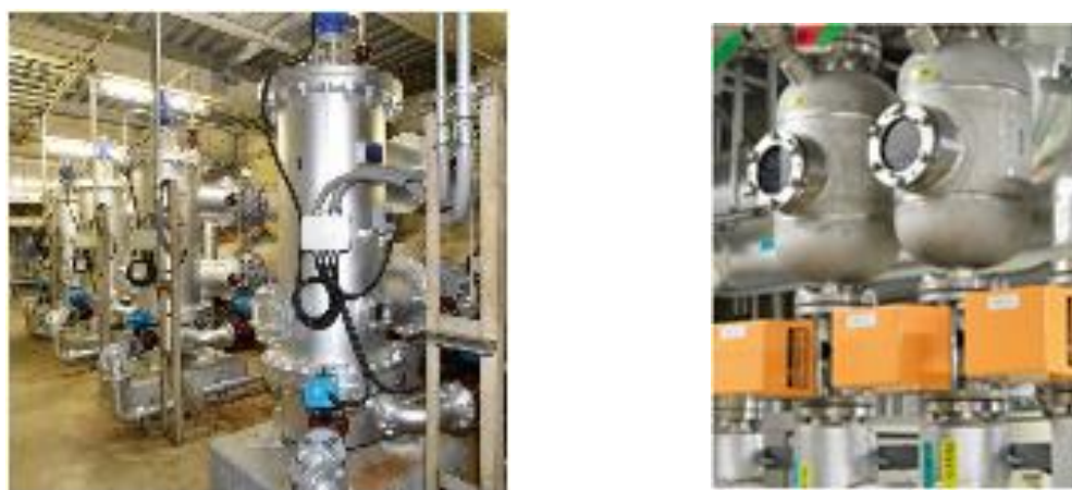
図 4.3.2 オートストレーナー(左)と自動ボール洗浄装置(右)の外観写真
