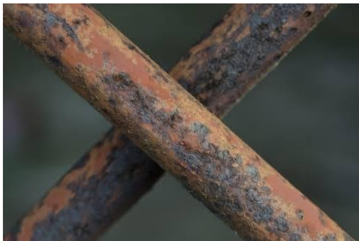
図 1-1 鉄の腐食事例(酸化鉄の生成)
