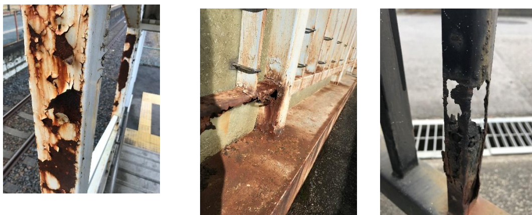
図 1-2 コーティング膜を持った鉄の腐食事例
