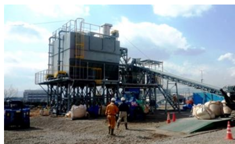
写真 3-5-1 石炭灰改良材プラント
